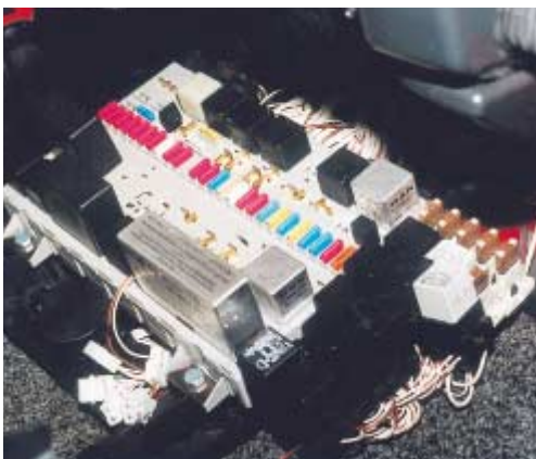
Klappbar: die Elektrozentrale im Beifahrerfußraum
