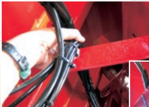
Leitungsbündel lose auf der Quertstrebe
