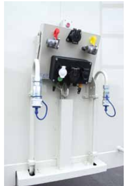
Anschluss-Panel an der Stirnwand
