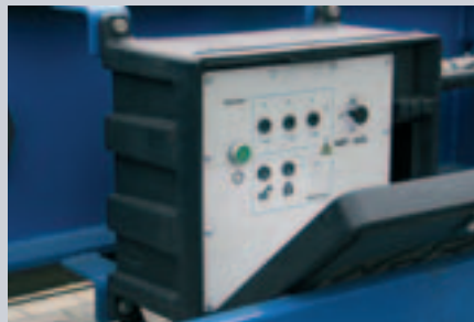
Automatisiert: Drehzapfenstellung und -verschluss an der Recotec-Anlage
