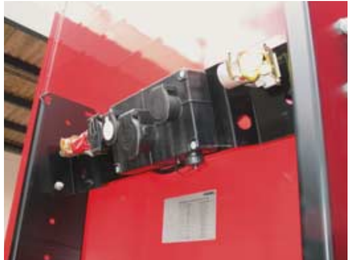
Kombiverteiler für die Elektrik
