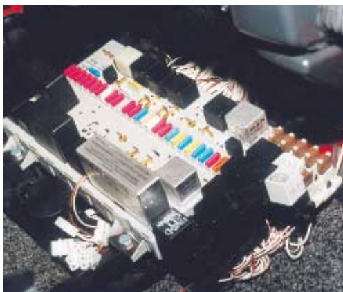
Klappbar: die Elektrozentrale im Beifahrerfußraum
