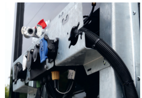
Ohne Beanstandung: die Luft-/Lichtkonsole an der Stirnwand; Einleitung in den Rahmen über Wellrohr
